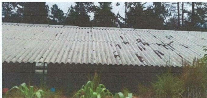
Foto1: Situación actual del estado del techo.
