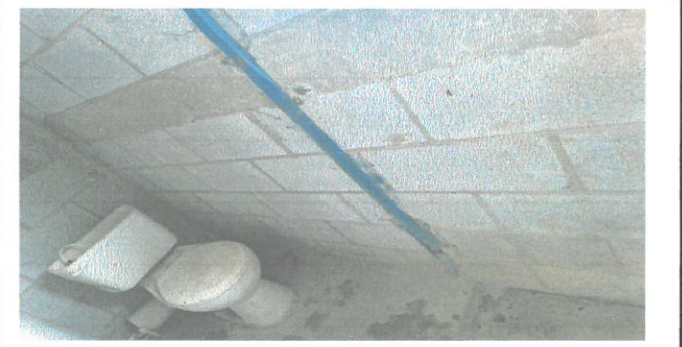
Foto 6: Fotografía mostrando sanitarios en mal estado
