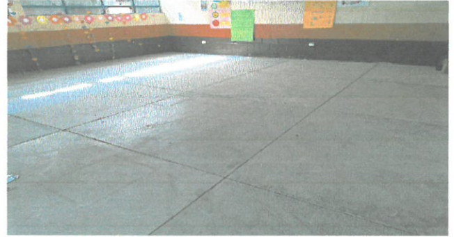
Foto 2: Salon con piso de concreto en mal estado.
