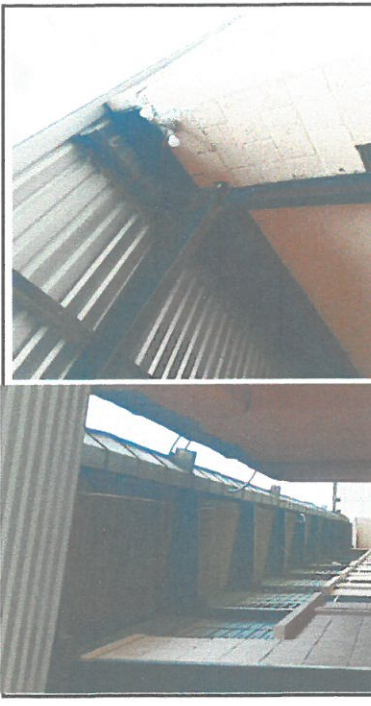
Foto 10 reparacion de sistema electrico en mal estado
