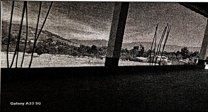
Vista del área a remozar con levantado de block y varandas de protección
