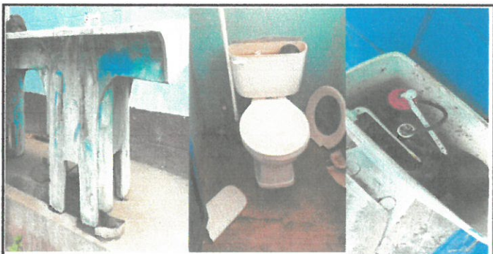
Foto 5: Pila y baños a cambiar
