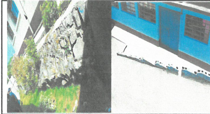
Foto 1: vista de los muros a remozar ya que ambos se están desmoronando
