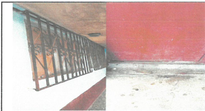
Foto 3: Vista de balcones y puertas en mal estado
