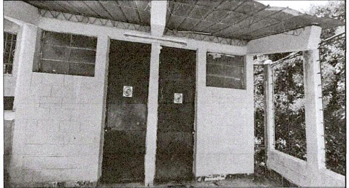
CONDICIONES DE INSTALACIONES DE SANITARIOS, TECHADO ROTO, PUERTAS OXIDADAS Foto No. 1.4
