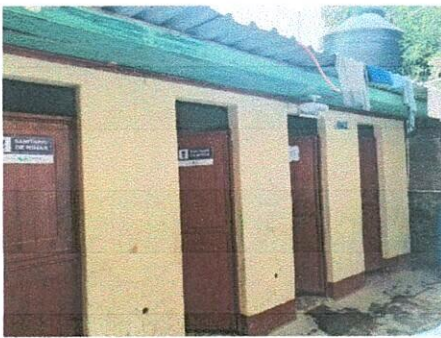
Foto 9: Estado Actual de los baños sanitarios.
