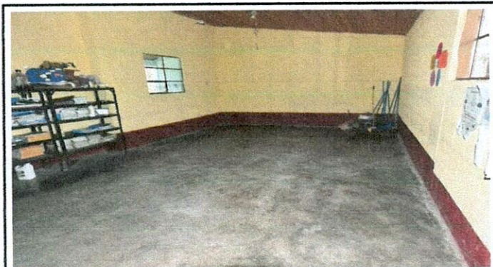
Foto 3: Aula 1: Piso torta de cemento en mal estado. (Se sustituye por piso ceramico)
