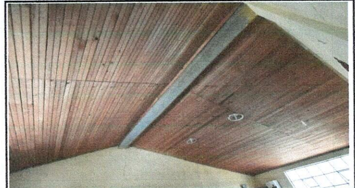
Foto 4: Aula 1: machimbre en mal estado y focos LED. (Se sustituyé por cielo falso PVC y lámparas LED)
