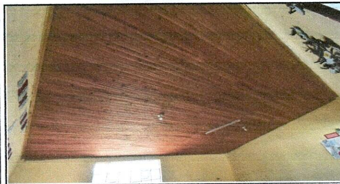
Foto 5: Aula 2: machimbre en mal estado y focos. (Se sustituye por cielo falso PVC y lámparas LED)
