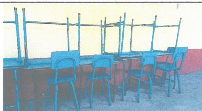
Foto 6: Mal estado de la pintura de mesas y sillas
