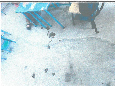
Foto 5: Deteriordo del piso de las dos Aulas
