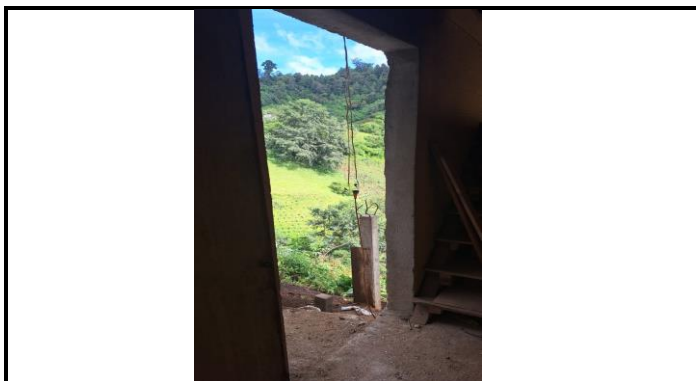
Foto 7: Sustrucción de puerta en bodega de alimentación
