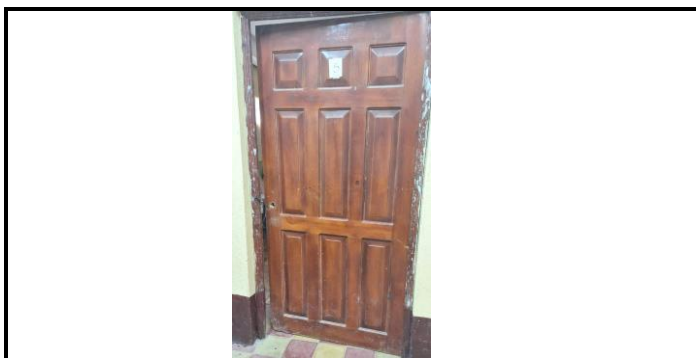
Foto 5: Aula de computación para sustitución de puerta
