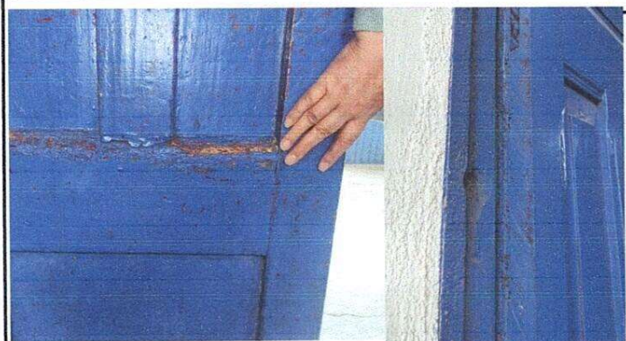
Foto 3: Restauración, tratamiento, accesorios y barnizado con poliuretano para exterior de puertas, presenta daños en ambos largueros con varios orificios ocasionados por el cambio constante de pasadores, alabadas, daños estructuras por polilla y no cuenta con accesorios.
