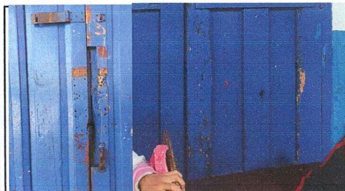
Foto 3: Restauración, tratamiento, accesorios y barnizado con poliuretano para exterior de puertas, presenta daños en ambos largueros con varios orificios ocasionados por el cambio constante de pasadores, alabadas, daños estructuras por polilla y no cuenta con accesorios.
