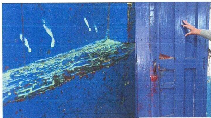
Foto 4: Restauración, tratamiento, accesorios y barnizado con poliuretano para exterior de puertas, por daños en ambos largueros, marcos de puerta, pestaña inferior, por daños estructurales por polilla y suministro de accesorios.
