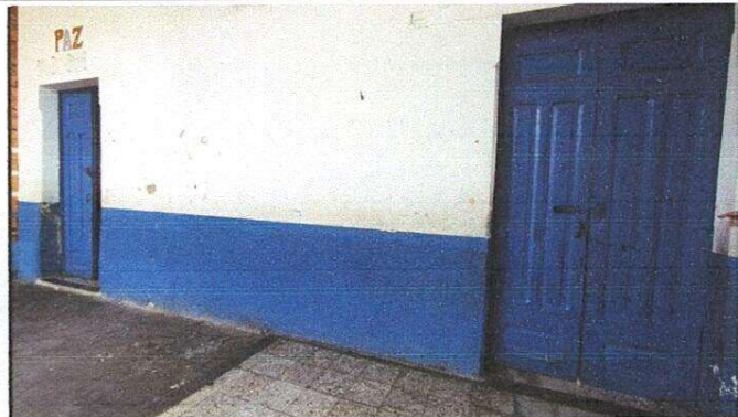
Foto 2: Restauración, tratamiento, accesorios y barnizado con poliuretano para exterior de puertas. Presenta daños en ambos centros de tableros y largueros por polilla, varios orificios ocasionados por el cambio constante de pasadores, alabadas.
