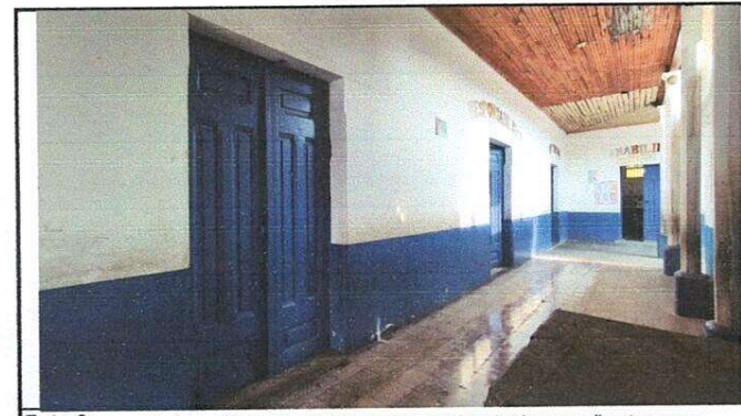
Foto 6: Restauración, tratamiento, accesorios y barnizado con poliuretano para exterior de puertas, por daños en ambos largueros con varios orificios ocasionados por el cambio constante de pasadores, alabadas y por polilla.
