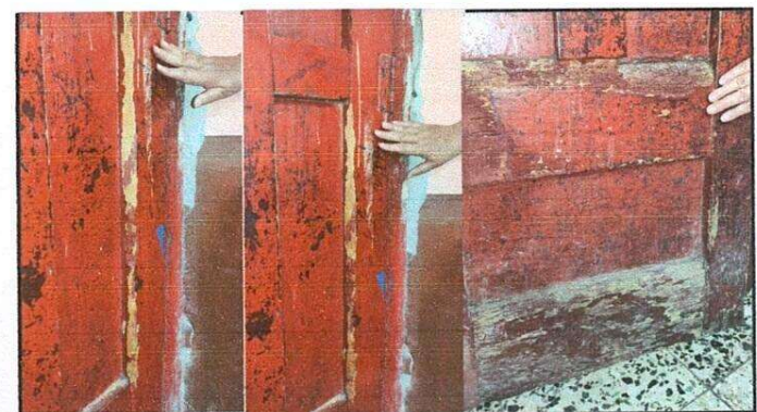
Foto 4: Restauración, tratamiento, accesorios y barnizado con poliuretano para exterior de puertas, por daños en ambos largueros, marcos de puerta, pestaña inferior, por daños estructurales por polilla y suministro de accesorios.
