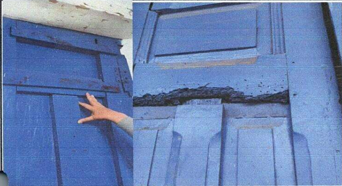
Foto 1: Restauración, tratamiento, accesorios y barnizado con poliuretano para exterior de puertas, por daños en ambos largueros con varios orificios ocasionados por el cambio constante de pasadores, alabadas y por polilla.
