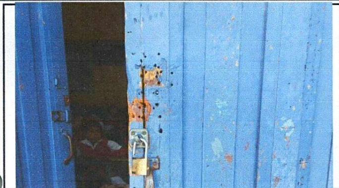
Foto 1: Restauración, tratamiento, accesorios y barnizado con poliuretano para exterior de puertas, por daños en ambos largueros con varios orificios ocasionados por el cambio constante de pasadores, alabadas y por polilla.
