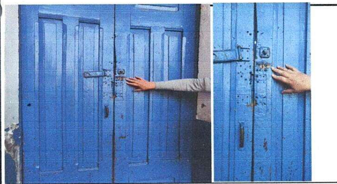
Foto 5: Restauración, tratamiento, accesorios y barnizado con poliuretano para exterior de puertas, presenta daños en ambos largueros con varios orificios ocasionados por el cambio constante de pasadores, alabadas, daños estructuras por polilla y no cuenta con accesorios.
