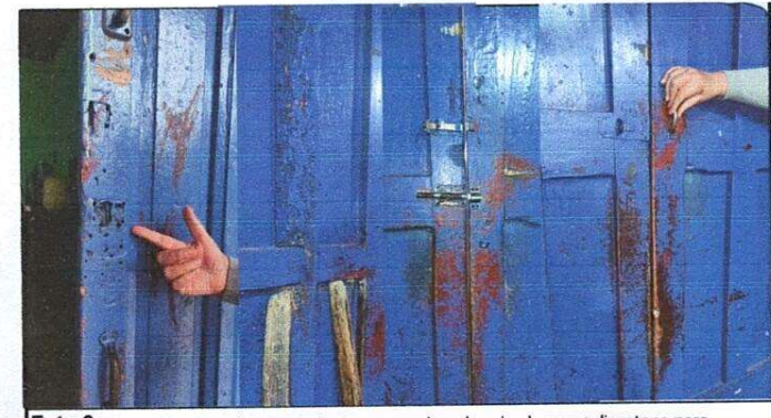
Foto 6: Restauración, tratamiento, accesorios y barnizado con poliuretano para exterior de puertas porque presenta daños en ambos largueros y daños estructurales por polilla.
