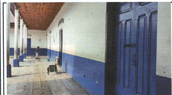
Foto 5: Restauración, tratamiento, accesorios y barnizado con poliuretano para exterior de puertas, por daños en ambos largueros con varios orificios ocasionados por el cambio constante de pasadores, alabadas y por polilla.
