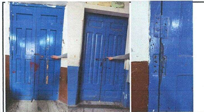
Foto 5: Restauración, tratamiento, accesorios y barnizado con poliuretano para exterior de puertas, presenta daños en ambos largueros con varios orificios ocasionados por el cambio constante de pasadores, alabadas, daños estructuras por polilla y no cuenta con accesorios.
