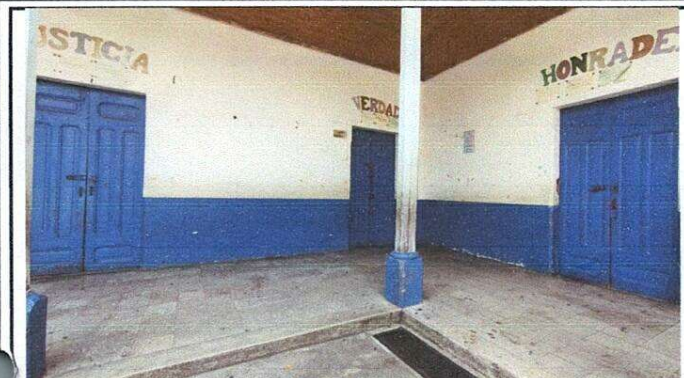
Foto 1: Restauración, tratamiento, accesorios y barnizado con poliuretano para exterior de puertas, por daños en ambos largueros con varios orificios ocasionados por el cambio constante de pasadores, alabadas y por polilla.
