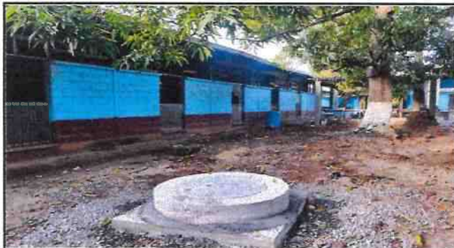
Foto 3: SUSTITUCIÓN DE POZO DE ABSORCIÓN CON TUBO DE CONCRETO DE 90CM X 300CM DE PROFUNDIDAD
