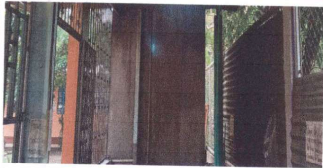
Foto 17: cernido en muros interiores del area de cocina
