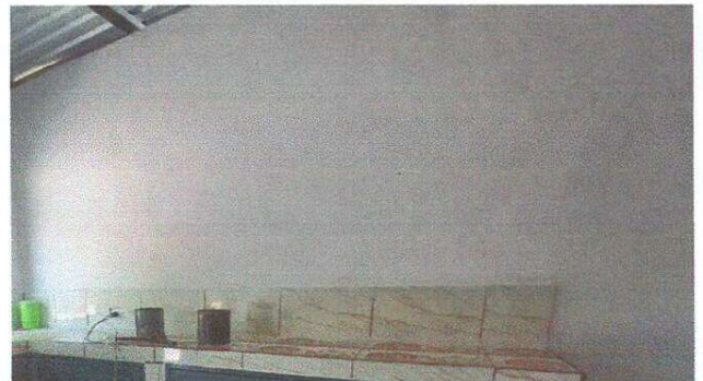
FOTO 4: REPELLO EN MURO INTERIOR DE COCINA Y GABINETE
