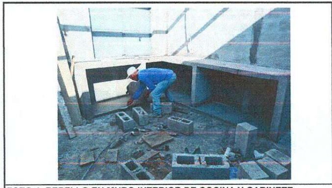
FOTO 4: REPELLO EN MURO INTERIOR DE COCINA Y GABINETE
