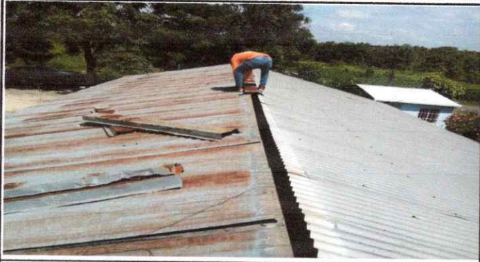
Foto1: Sustitución de cubierta de techo de lamina troquelada calibre 26 de las aulas de la EORM.
