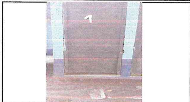
Foto 2: Sustrucción de puerta de inodoro
