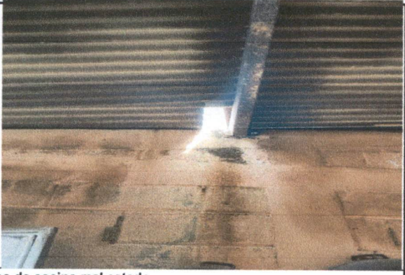
Foto1: Techo de cocina mal estado
