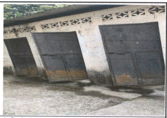
Foto 3: Puertas de Sanitarios en mal estado
