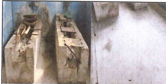
Foto 6: Sustitución de estufa rural (completa) incluye chimenea y plancha de metal y sustitución de piso de concreto por cerámico.
