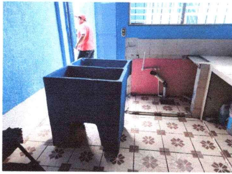
Cambio de lavatrastos por pila de 1 lavadero en cocina escolar, módulo Norte
