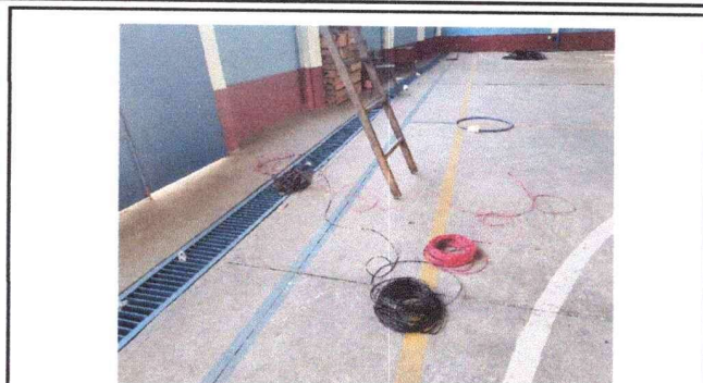
Cambio de cableado de energía eléctrica en cancha escolar, instalación de 2 lámparas Led, Módulo sur
