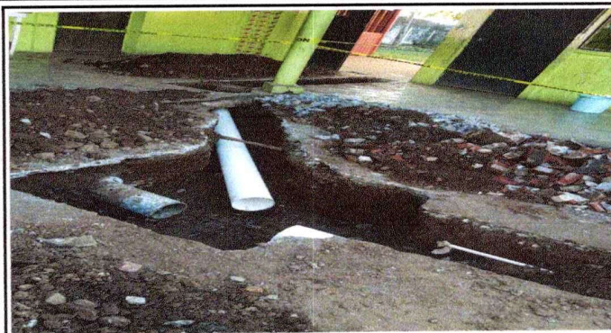
Foto 2: Reposadera de agua y rejilla que debe ser sustituida.
