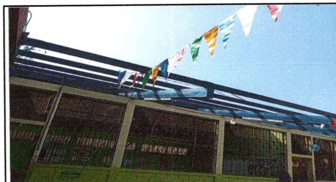
Foto 4: Techo de dos aulas que debe ser sustituido.
