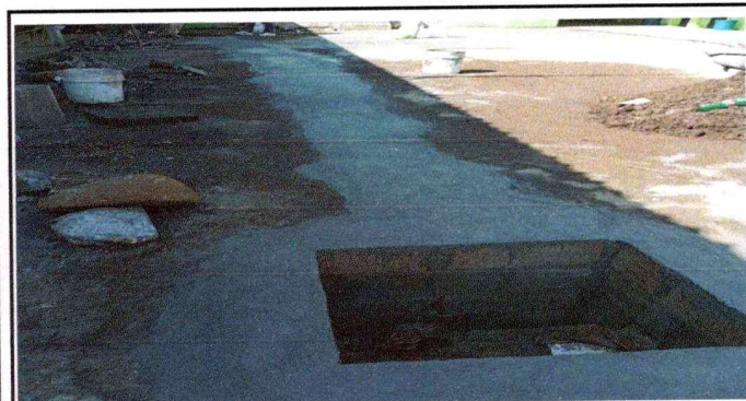
Foto 3: Trayecto de drenaje que debe ser sustituido.
