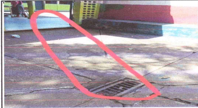
Foto 1: Reposadera de agua, rejilla, torta de concreto y piso de granito que debe ser sustituido.
