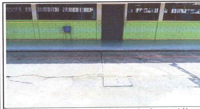
Foto 5: Caja de registro y paso de tubería de drenaje y de agua potable que debe ser sustituido.
