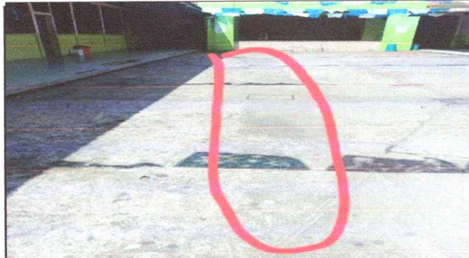
Foto 3: Trayecto de drenaje que debe ser sustituido.
