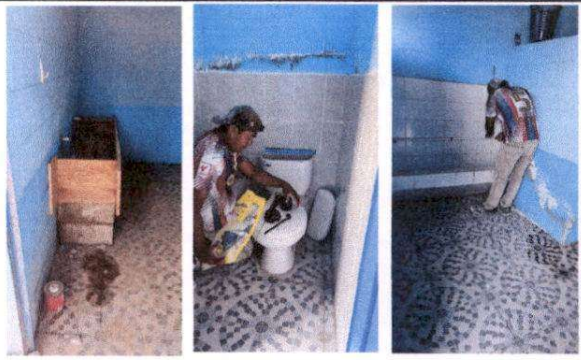
Foto 4: Sustitución de lavamanos por lavamanos de concreto, cambio de accesorios de inodoros y sustitución de llaves de paso para mijitorios.
