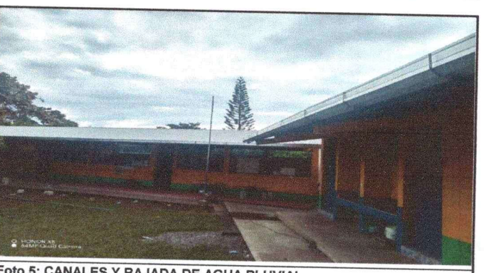
Foto 5: CANALES Y BAJADA DE AGUA PLUVIAL
