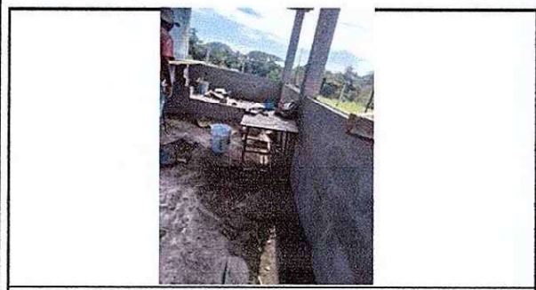
Foto 5: Cernido en corredor de cocina
