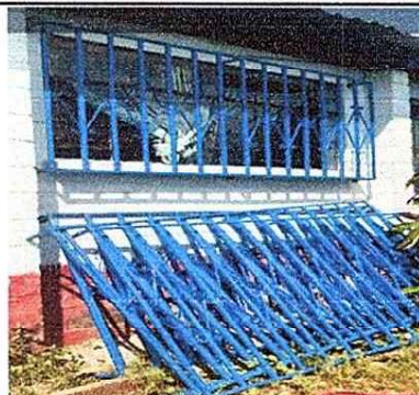
Foto 4 Balcones de metal instalados en todas las aulas
