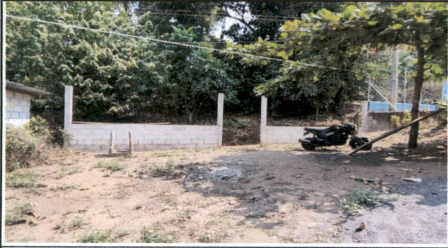
TERMINACION DE MURO PERIMETRAL Y COLOCACION DE MALLA DE 1.5 METROS DE ALTO
