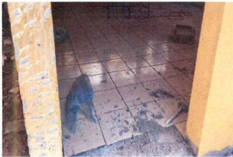
Foto 3: Sustitución de piso de torta derriado a grietas que presenta.
