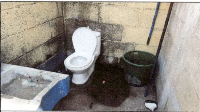
Foto 5: solicitan la reparación y mantenimiento de servicio sanitario ubicado en el exterior.
