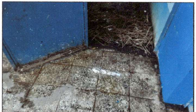
Foto 4: Estado actual de los servicios sanitarios, solicitan trabajos de reparación y mantenimiento ya que debido a su estado han quedado inhabilitados.
