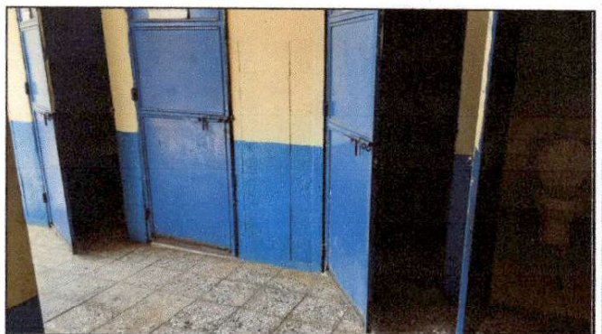
Foto 6: Debido al deterioro de varias puertas metálicas en servicios sanitarios y aulas, solicitan su cambio para el mejoramiento de la seguridad.
