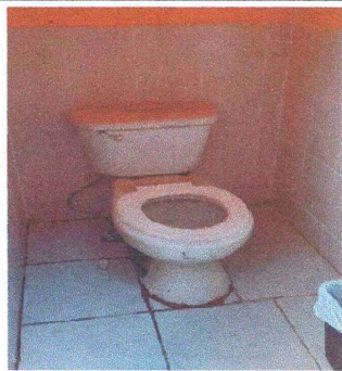
Foto 9: Instalación de azulejo a un metro del suelo en los sanitarios y se coloca piso cerámico (seis en total).
