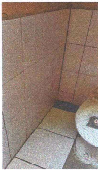
Foto 9: Se instala azulejo a un metro del suelo en los sanitarios y se coloca piso cerámico (seis en total).
