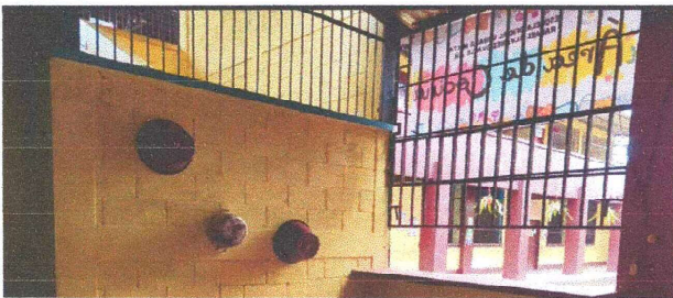
Foto 3: Los balcones no han tenido mantenimiento y no se cuenta con un espacio asignado para guardar los utensilios
