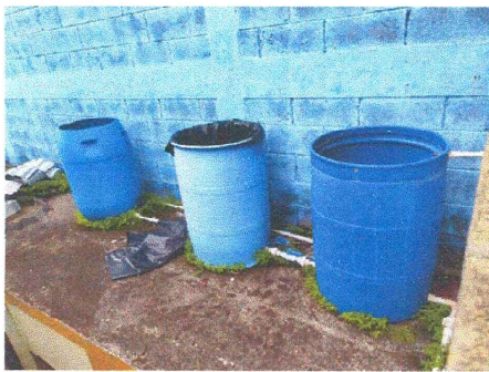
Foto 9: Depositos de agua sobre losa de sanitarios ya no son funcionales y no tienen tapadera, se utiliza nylon para taparlos.
