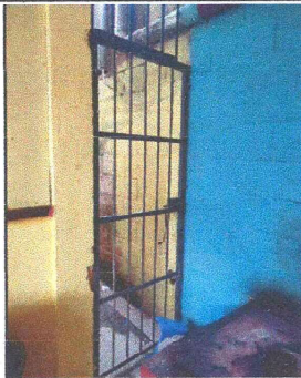
Foto1: Puerta de reja que necesita forrarse para evitar que ingrese contaminación a la cocina.
