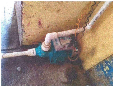
Foto 11: La bomba de agua ya no funciona.
