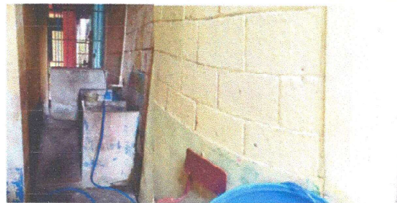
Foto 10: La pila de los sanitarios solamente tiene un lavadero provocando que los estudiantes no tengan espacio para lavarse las manos.
