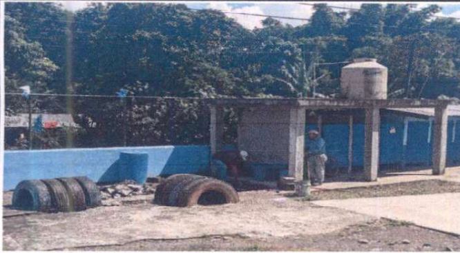
Foto 19: Reparación de muro perimetral de block con tubo hg y malla galvanizada, soleras intermedias y columnas
