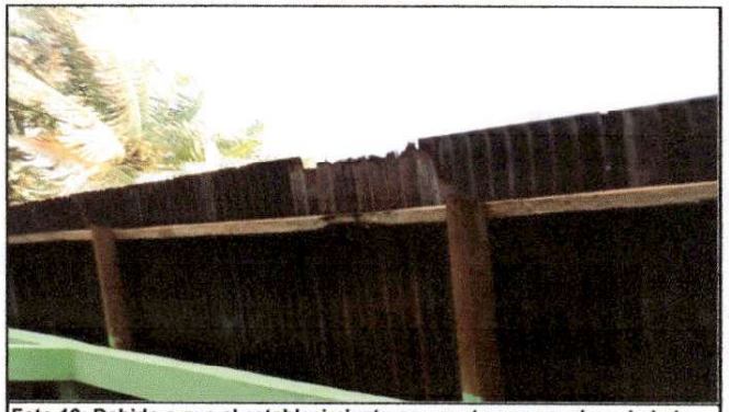
Foto 12: Debido a que el establecimiento no cuenta con canales y bajadas de agua pluvial, se solicita el suministro e instalación de estos mismos.
