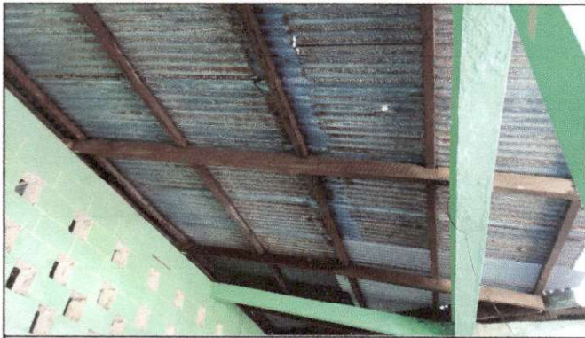
Foto 3: Estado actual de la cubierta de lámina, solicitan el cambio de esta misma ya que se encuentra muy deteriorada.
