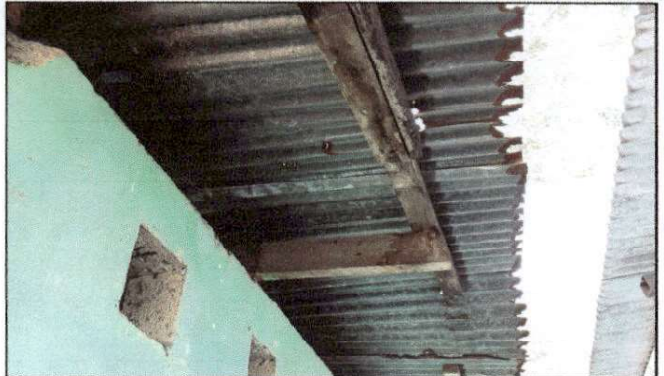
Foto 8: Estado actual de la estructura de madera, solicitan el cambio de esta misma por una estructura metálica.
