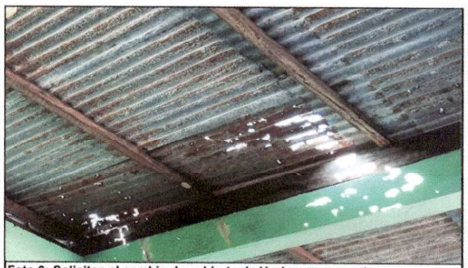
Foto 6: Solicitan el cambio de cubierta de lámina, ya que esta se encuentra muy deteriorada en gran parte del establecimiento.
