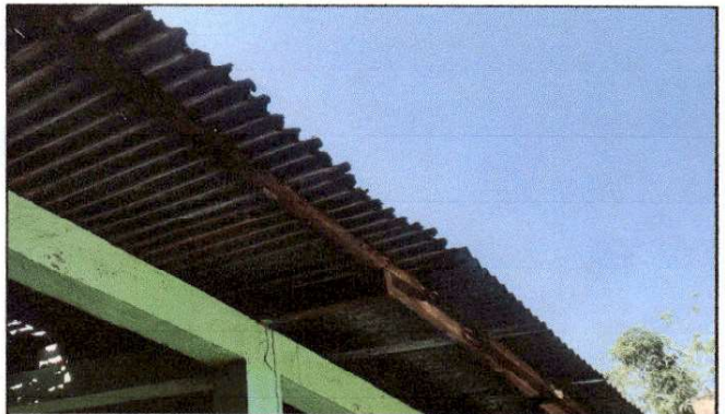
Foto 10: Se solicita el suministro e instalación de canales y bajadas de agua pluvial, ya que no se cuenta con estos canales en ningún módulo de la escuela.
