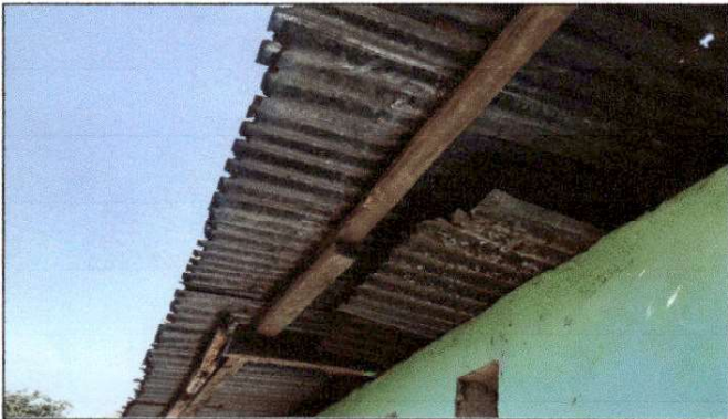
Foto 9: Solicitan el cambio de estructura de madera por estructura metálica.
