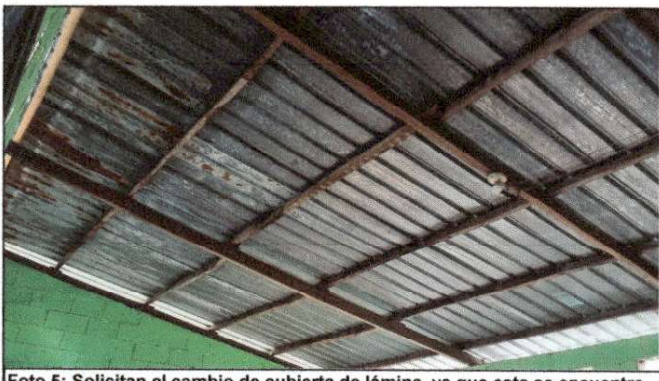
Foto 5: Solicitan el cambio de cubierta de lámina, ya que esta se encuentra muy deteriorada en gran parte del establecimiento.
