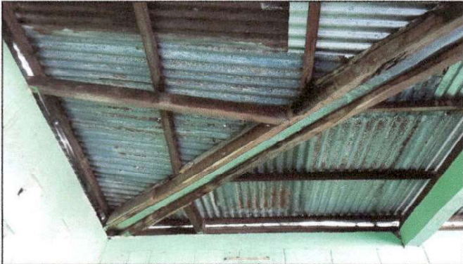
Foto 7: Estado actual de la estructura de madera, solicitan el cambio de esta misma por una estructura metálica.
