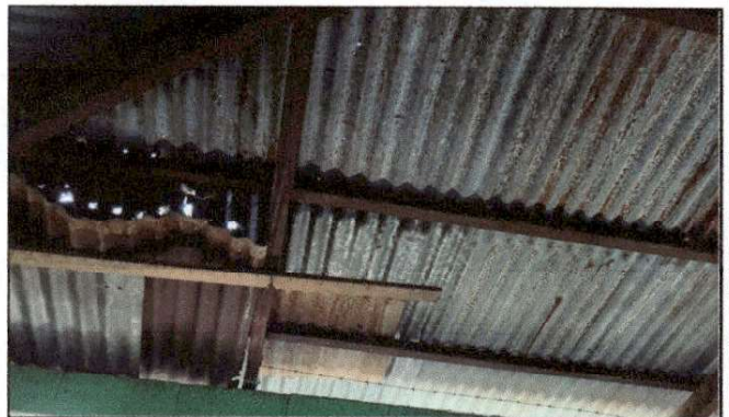
Foto 4: Estado actual de la cubierta de lámina, solicitan el cambio de esta misma ya que se encuentra muy deteriorada.
