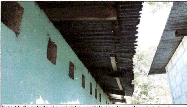
Foto 11: Se solicita el suministro e instalación de canales y bajadas de agua pluvial, ya que no se cuenta con estos canales en ningún módulo de la escuela.
