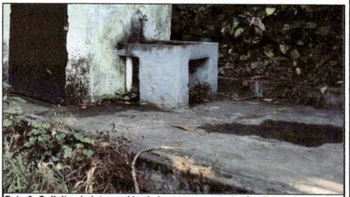
Foto 6: Solicitan la integración de lavamanos exterior fundido, además de la colocación de muro de cerramiento en dicha área, ya que se presentan problemas muy serios de seguridad.
