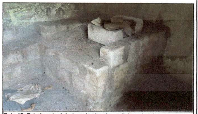
Foto 12: Estado actual de área de plancha, solicitan el mejoramiento de dicha área por temas de higiene.
