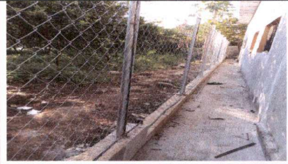
Foto 13: Sustitución de alambre espicado y postes de madera por tubo Hg y malla galvanizada.
