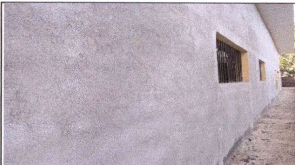
Foto 10: Repello en muro exterior trasero en aula módulo 2
