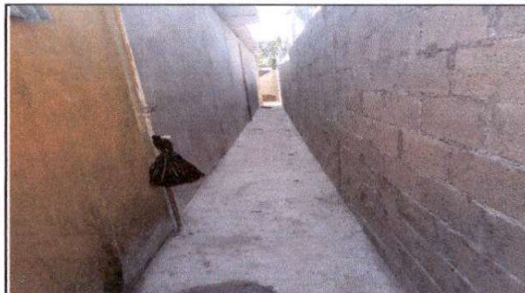
Foto 4: Repello en muro exterior trasero
