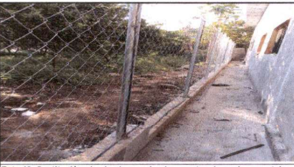
Foto 13: Sustitución de alambre espicado y postes de madera por tubo Hg y malla galvanizada.
