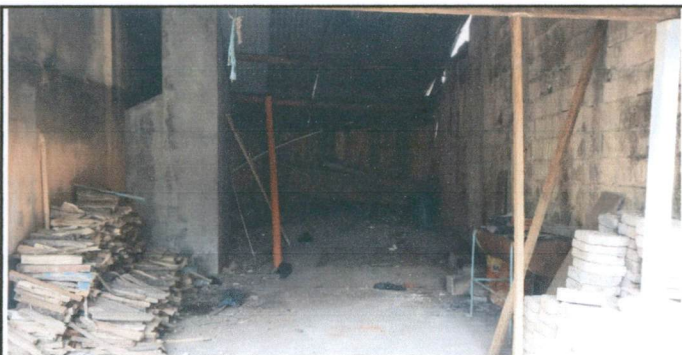
Foto 5: Sustitución de piso por piso cerámico, reparación de chimenea, sustitución de cubierta de lámina y sustitución de estructura de soporte de madera por metal
