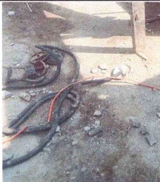
Foto 9: REPARACIÓN DE SISTEMA ELÉCTRICO, Se retiraron el cableado, plafonera y lámpara ya que estaba defectuosa por constante humo generado por el fuego.
