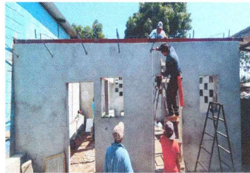
Foto 10: MANO DE OBRA ESPECIALIZADA, Se mandó a fabricar Puerta, Ventana, Estructura Portante, Láminas e instalaciones eléctricas y desinstalación de estructura y lámina.
