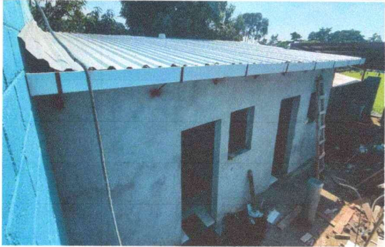
Foto 1: CUBIERTA DE LAMINA, Se procedió a colocar el nuevo techado de la cocina.
