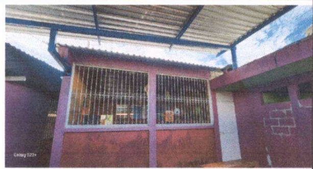
Foto 2: Aulas sin ventanas de vidrio
