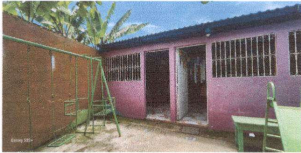
Foto 3: Aulas sin ventanas de vidrio
