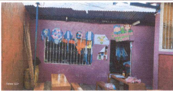
Foto 5: Estructura de lamina sin canal de bajada de agua
