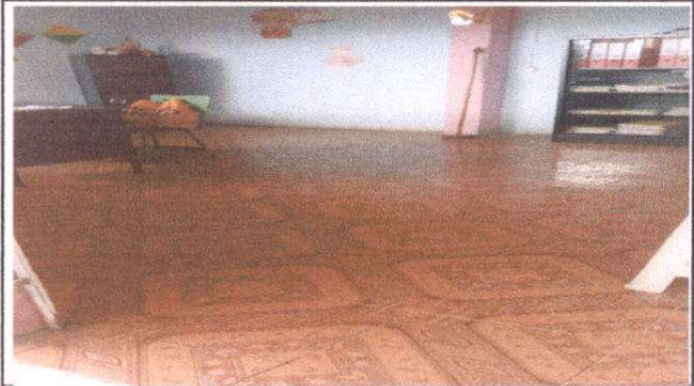
Foto 4: Piso de aula que necesita ser cambiado.
