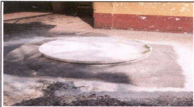
Foto 3: Pozo artesanal con mal funcionamiento
