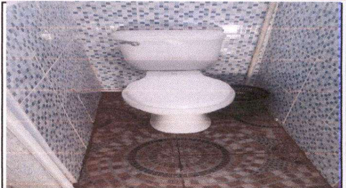
Foto 2: Inodoros de nivel preprimario con mal funcionamiento en drenaje
