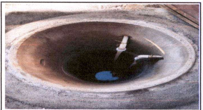
Foto 4: Pozo artesanal con mal funcionamiento
