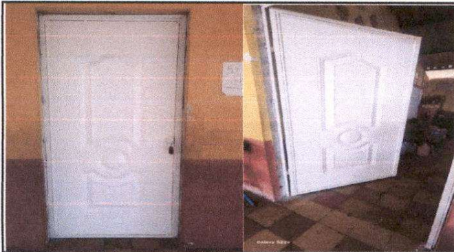
Foto1: Puertas de madera de aulas en malas condiciones
