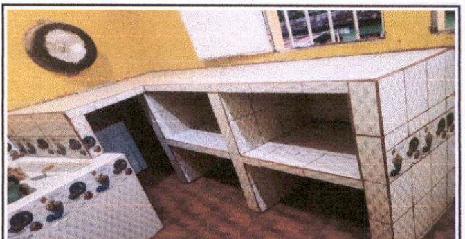
Foto 6: Mesas de trabajo de cocina en mal estado
