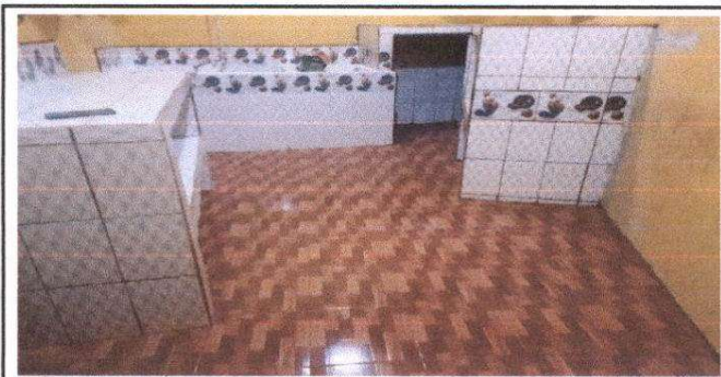
Foto 5: Pila de cocina en malas condiciones
