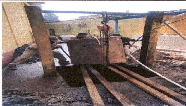
Foto 3: Pozo artesanal con mal funcionamiento
