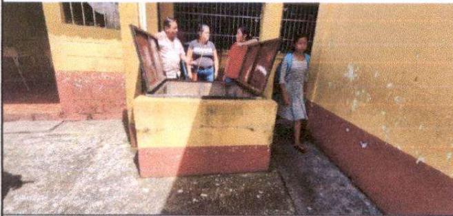
Foto 3: Pozo artesanal con mal funcionamiento
