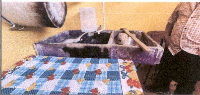
Foto 5: Pila de cocina en malas condiciones
