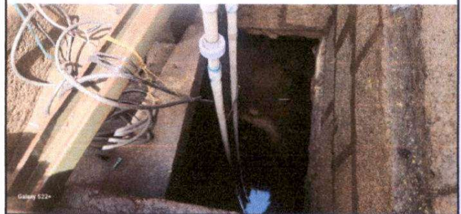
Foto 4: Pozo artesanal con mal funcionamiento
