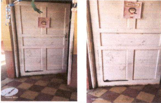
Foto 1: Puertas de madera de aulas en malas condiciones
