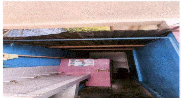
Foto 2: Techo de duralita de sanitarios en mal estado
