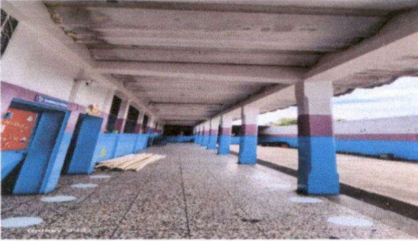
Foto 1: Techo de duralita en malas condiciones
