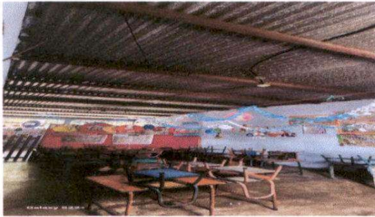
Foto 3: Techo de lamina presenta agujeros
