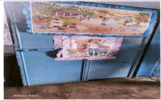
Foto 6: Puertas de metal en mal estado
