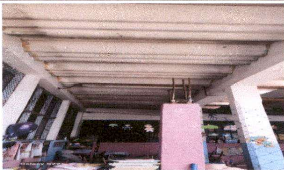
Foto 5: Techo en mal estado
