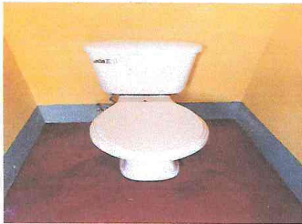
Foto 15: Sustitución de accesorios de inodoro (Contrallave, manguera de abasto y accesorios de tanque).
