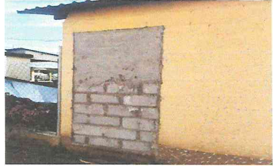
Foto 2: Cerramiento en muro con levantado de block y en cocina.
