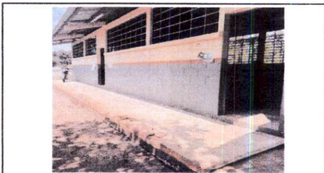
Foto 10: Sustitución de piso de granito por piso de patio en corredor de aulas. Sustitución de lámina y estructura de techo de aulas.
