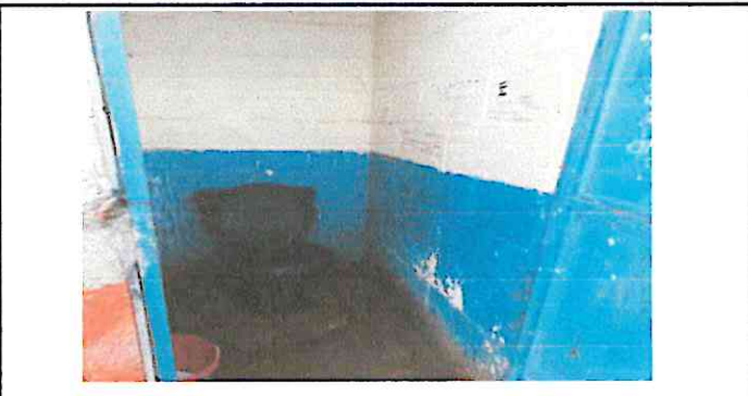
Foto 5: Sanitarios en deterioro con problemas en drenaje.
