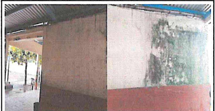
Foto 4: Filtración de agua por deterioro de canal de concreto que pasa sobre la pared en el interior del aula.
