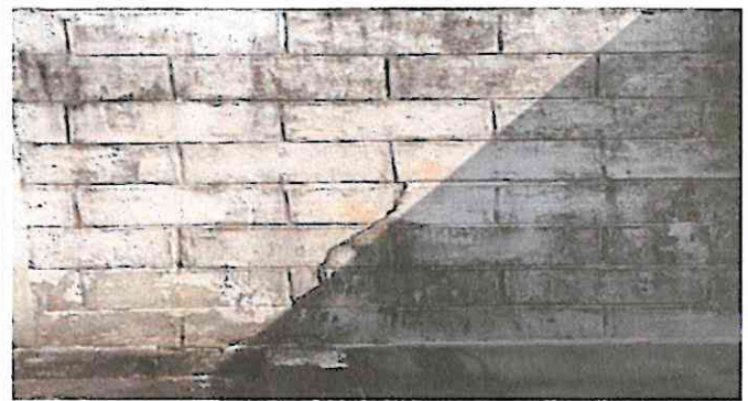
Foto 2: Fisura en muro perimetral cercano a baños.
