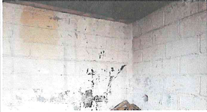
Foto 1: Fisura en pared de muro perimetral cercano a cocina.
