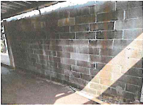
Foto 3: Pared deteriorada por caída de agua de lluvia.
