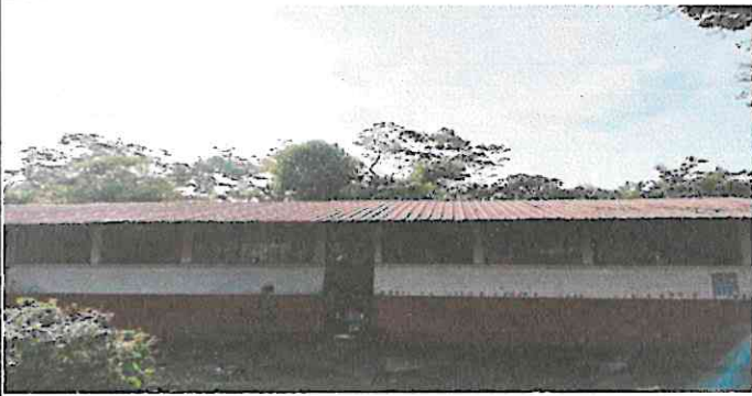
Foto 1: Láminas deterioradas de dos caídas de agua y canal faltante de 4 aulas.
