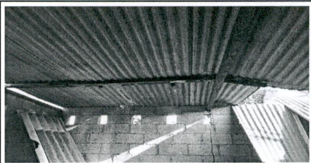
Sustitución de cubierta de lámina y estructura de techo en bodega, reparación de cableado eléctrico.
