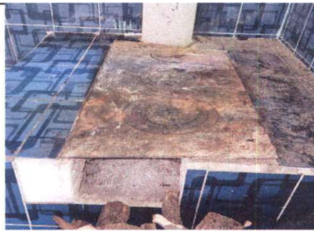
Foto 4: Sustitución de plancha de estufa rural dañada por plancha de estufa
