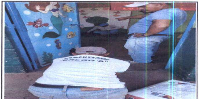
Foto 6: albañiles trabajando en las medidas respectivas para colocar piso en el aula tres
